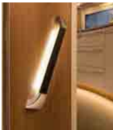
+ Escalón de acceso iluminado (1)
